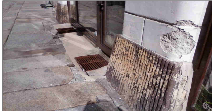
Foto 9: Beschädigte Hausfront im Südteil der Buchholzer Straße
