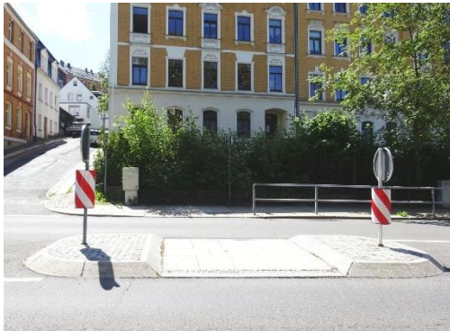
Foto: Querungshilfe Geyersdorfer Straße, kein RegelmäÙ, für Mindestanforderungen ausreichend (nicht barrierefrei)
